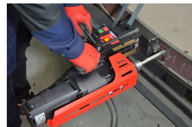
Foratura fuori posizione
