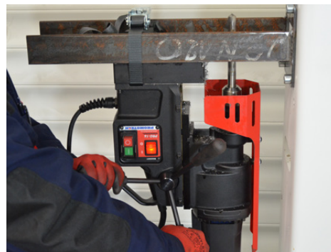
Foratura fuori posizione
