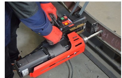
Foratura fuori posizione
